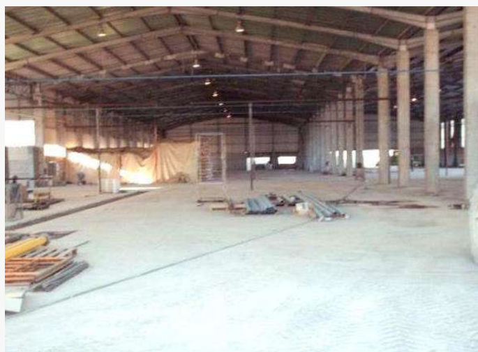
Fábrica de Cortiça | Cork Plant, Equipar, Coruche
